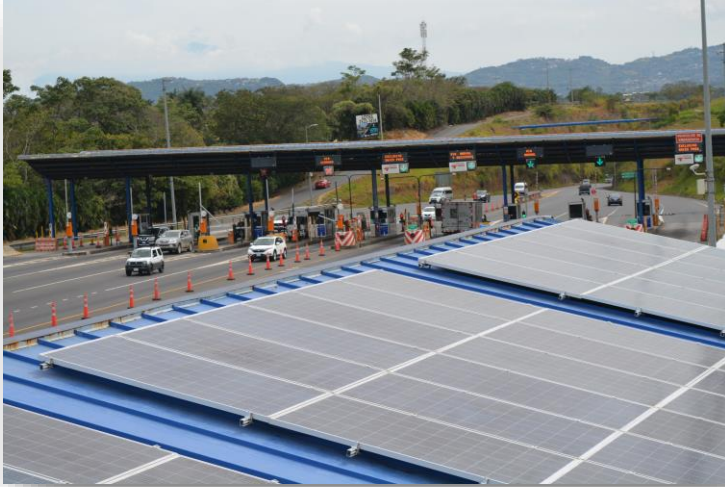
Paneles solares para operación de peajes y cámaras a lo largo de la ruta.
