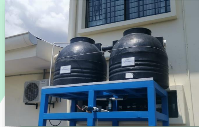
Sistema de captación de aguas pluviales
